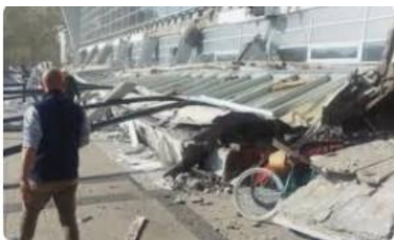
突然、駅の屋根が崩壊、下敷きになり14人が死亡【セルビア...
